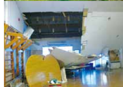
「仙台つどいの家」の外観(上)と天井の落下した建物内(下)
